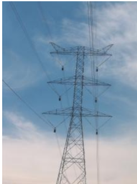
Vista de torre del doble circuito a 400 KV en construcción, en Mayo del 2006.
