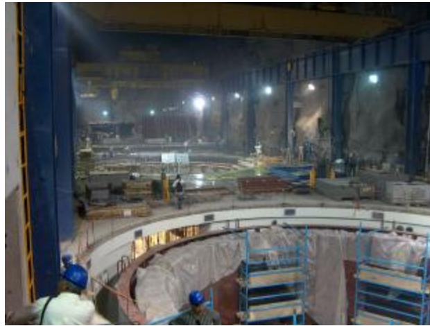
Vista de Casa de Máquinas a Mayo del 2006.
