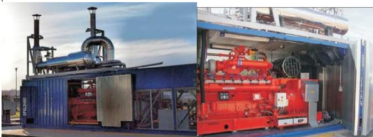
(Vista general de la planta y del primer generador).
