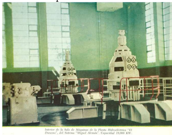
Interior de la Sala de Máquinas de la Planta Hidroeléctrica "El Durazno", del Sistema "Miguel Alemán", Capacidad 18,000 KW.
